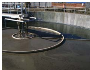
Depuradoras de aguas
